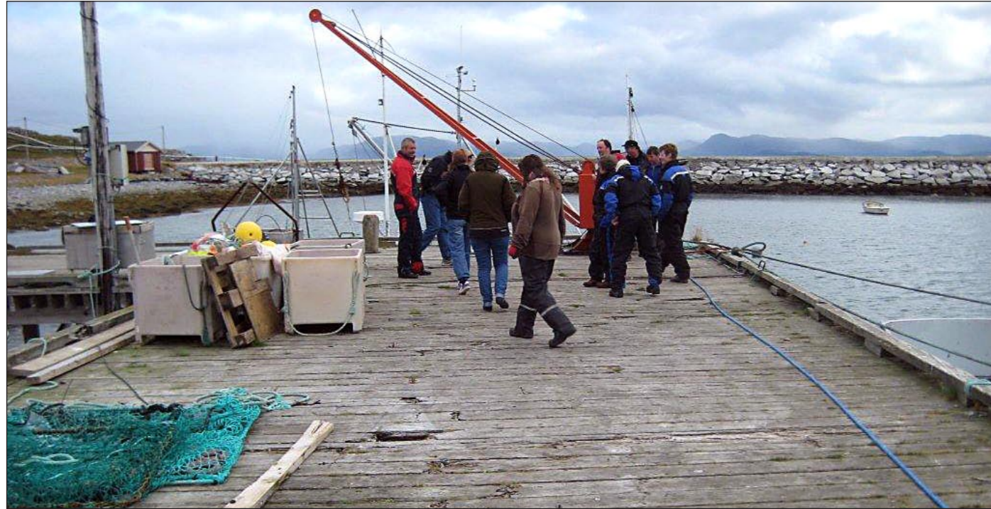
Kaianlegget på Veidnes er i skral forfatning. Men for 390.000 kroner vil den kunne få nytt dekke og fenderingsverk.
